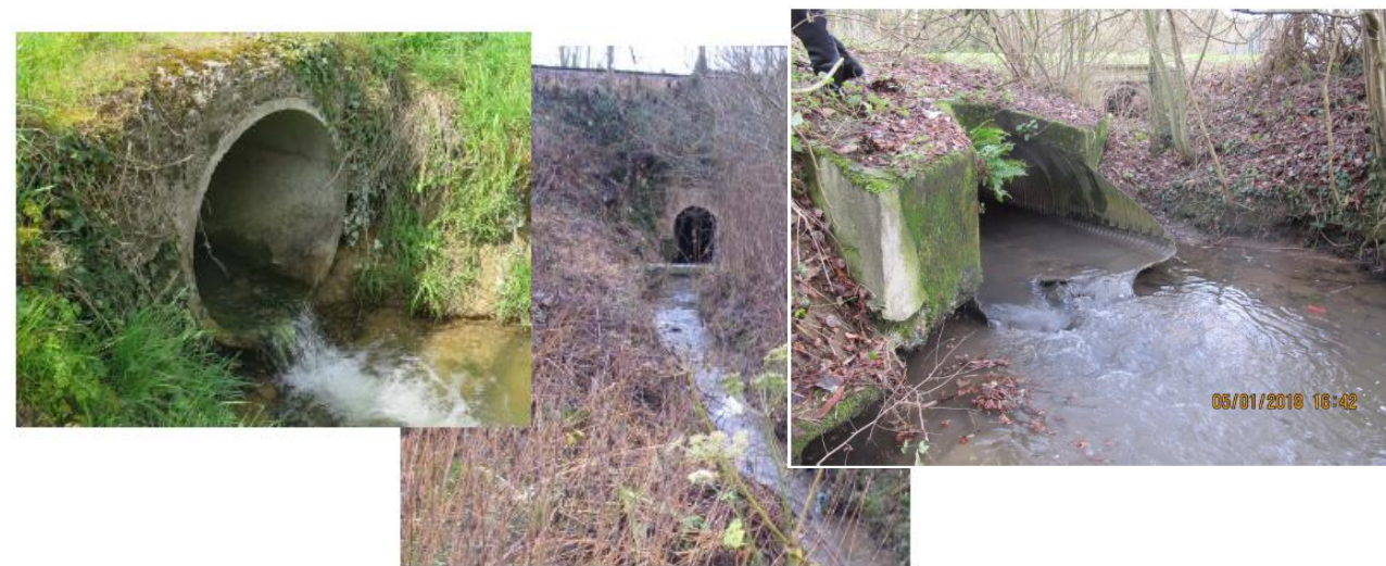
Figure 14 : Exemples d'ouvrages du bassin versant de la Brèche constituant un obstacle à la circulation piscicole (de gauche à droite : Buse sur le Ru de Coutance à Neuilly-sous-Clermont, buse sous la voie SNCF sur le Ru de Coutance à Rantigny, buse sous la D158 sur l'Arré à Saint-Just en Chaussée)
